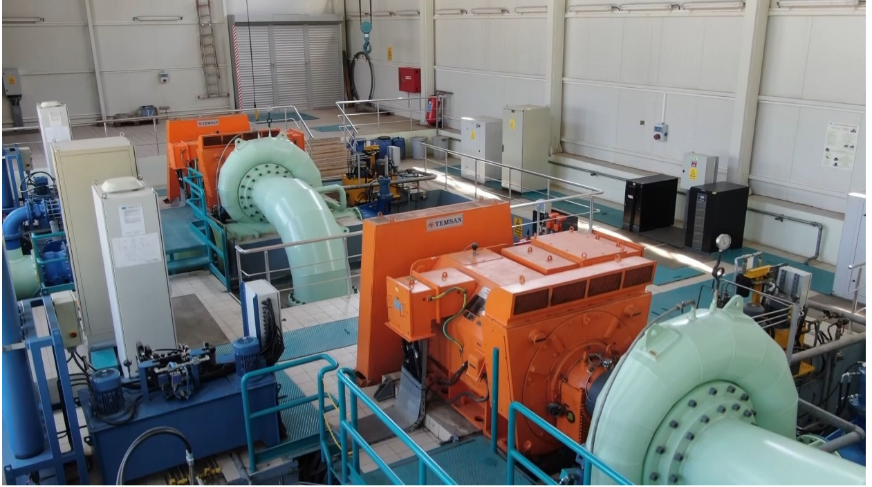
Yuvacık Hidroelektrik Santrali
